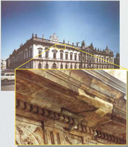
Abb. 1 : Zeughaus mit einem Teilbereich des durchfeuchteten Hauptgesims-Traufbereiches
